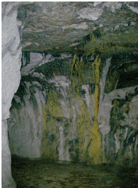
photo 3: Galerie sujette aux infiltrations en pied de versant (carrière Interparlementaire des Chênes)
