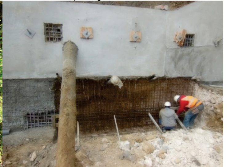
photo 10: Vides recoupés par des travaux de construction côté ouest (source : Géolia)
